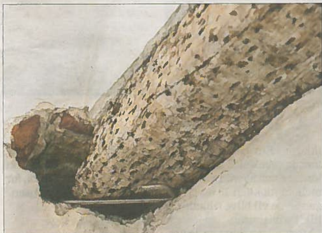
Den gamle, rådne bjælke over den tilmurede kvindeindgang må ikke fjernes. I stedet skal den understøttes af en jernbjælke.
